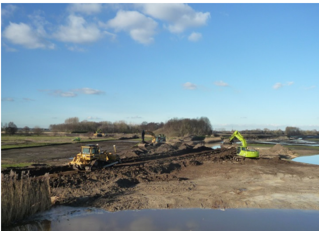
Foto 1 Met zwaar materieel wordt voor het grootste deel van het Diessens Broek de zwaar bemeste teeltlaag afgegraven.
